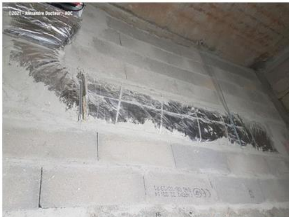
Concours photos des désordres dans le bâtiment de l'AQC, juin 2021. © AQC
